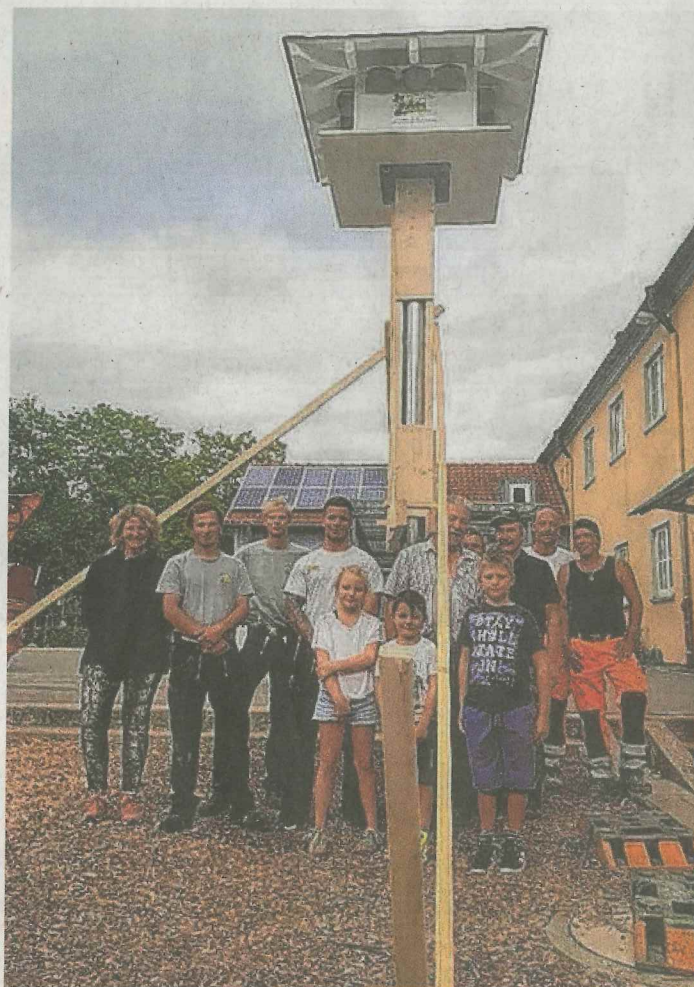
Die Helfer (von links): Christa Lilienfein (Schulleiterin Grundschule Bibersfeld), Marcel Fischer (Geselle Müller Holzbau), Sören Rothenberger (Azubi Müller Holzbau), Chris-André Müller (Müller Holzbau), Joy Ebert, Lio Ebert, Helmut Müller (Müller Holzbau), Peter Gottschling (Hausmeister Grundschule Bibersfeld), ein Grundschüler, Gerhard Immel, Michael Setzer (Haller Werkhof) und Christian Thissen (Haller Werkhof).
